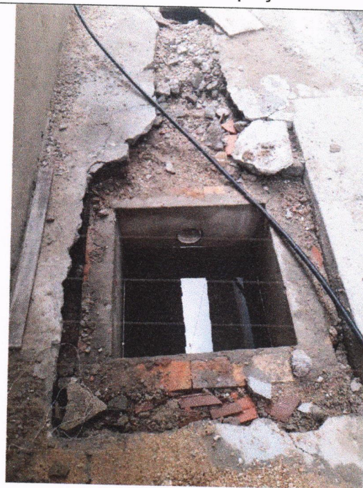
Caixas de Inspeção
