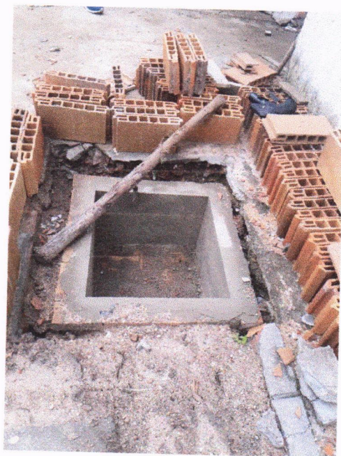
Caixas de gordura
