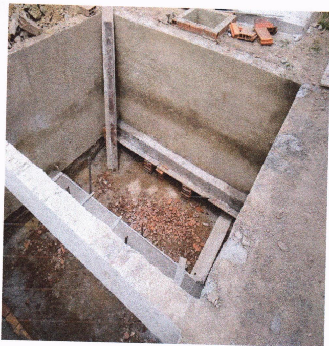
Unidade de tratamento de esgoto
