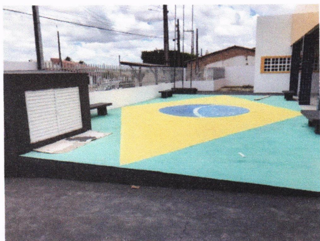
Abrigo de hidrante para incêndio
