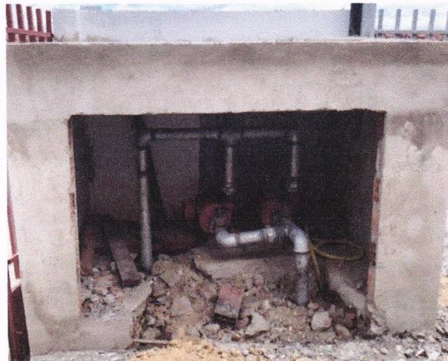
Prateleira em alvenaria cerâmica e revestida
