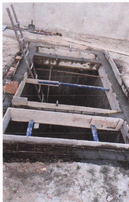
Unidades de Tratamento de Esgoto
